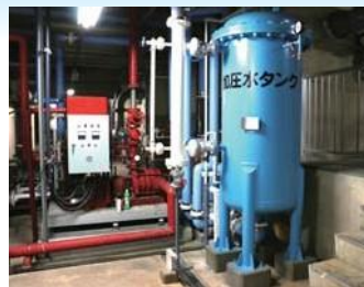
加圧浮上装置
