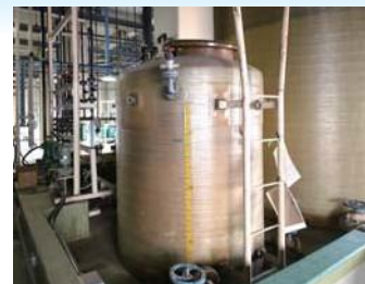
次亜塩素酸貯留タンク
