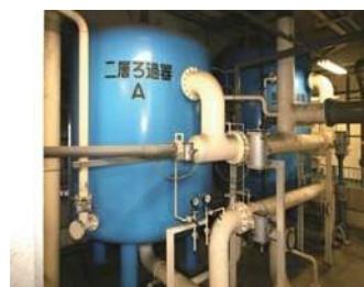
二層ろ過器設備
